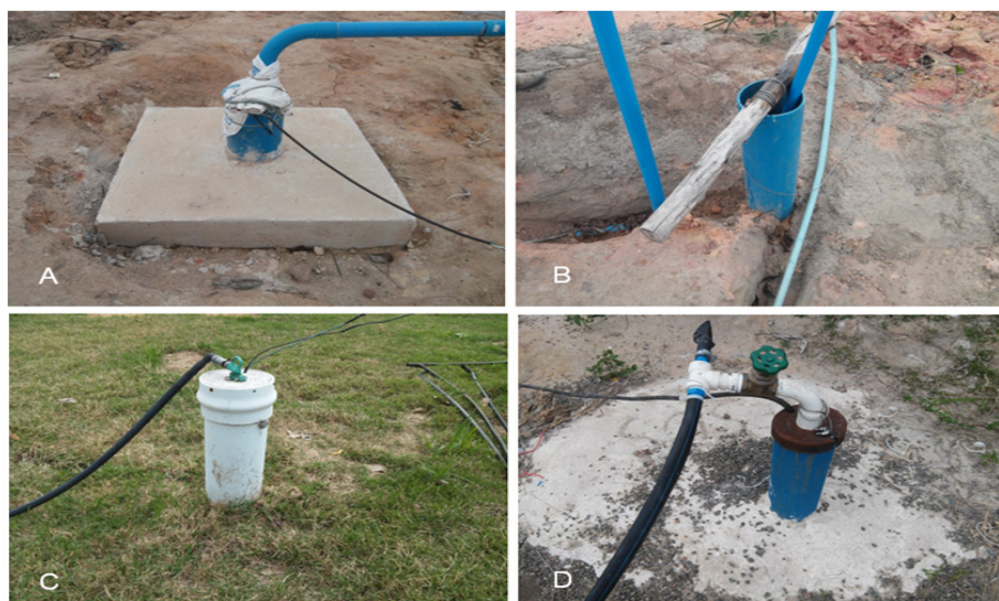
Figura 3. Poços tubulares no município de Boa Esperança – ES, fora das normas ABNT/NBR 12212 e ABNT/NBR 12244. Fonte: Autor, 2016.
