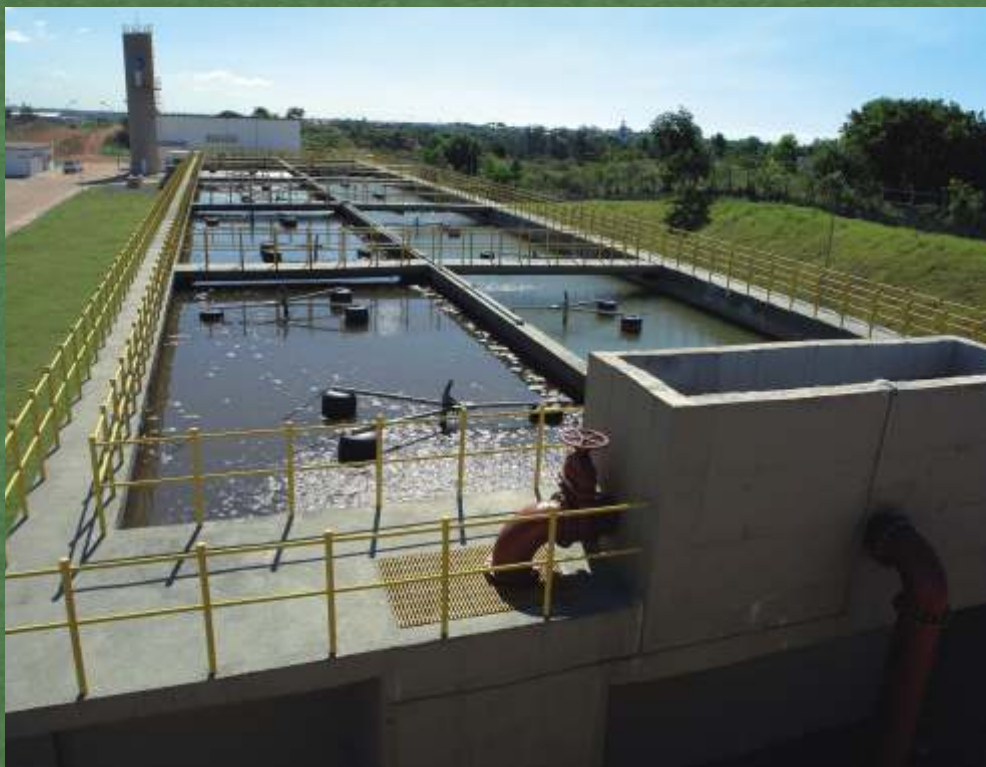
FIGURA 1 - Estação de Tratamento de Esgoto (ETE).
