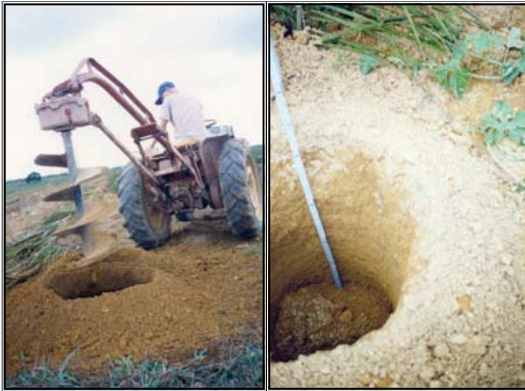
Figura 11. “Brocão” – broca de solo com diâmetro de 18” empregada em abertura de covas.
