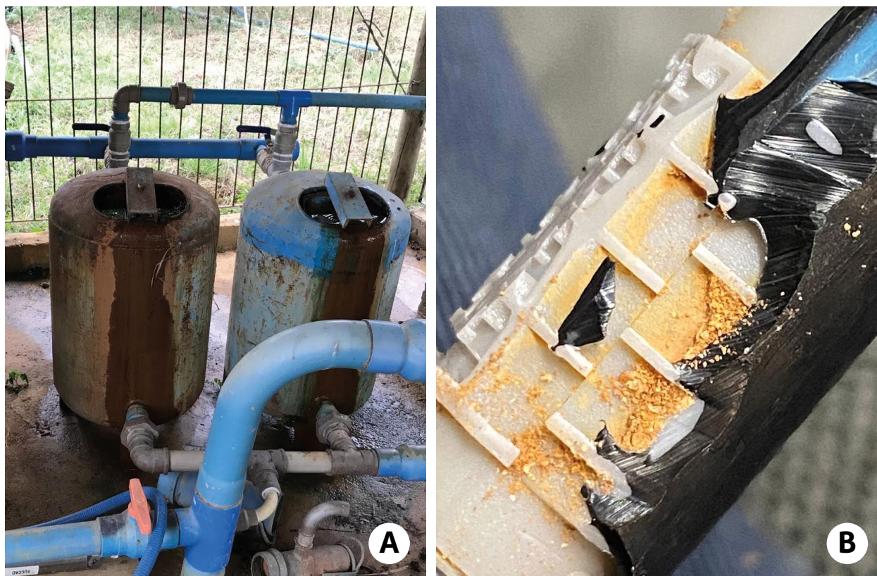
Figura 14 – Filtros de irrigação por gotejamento com sintomas de presença de ferro (Fe) na água (A) e corte transversal em gotejador com entupimento (B).
