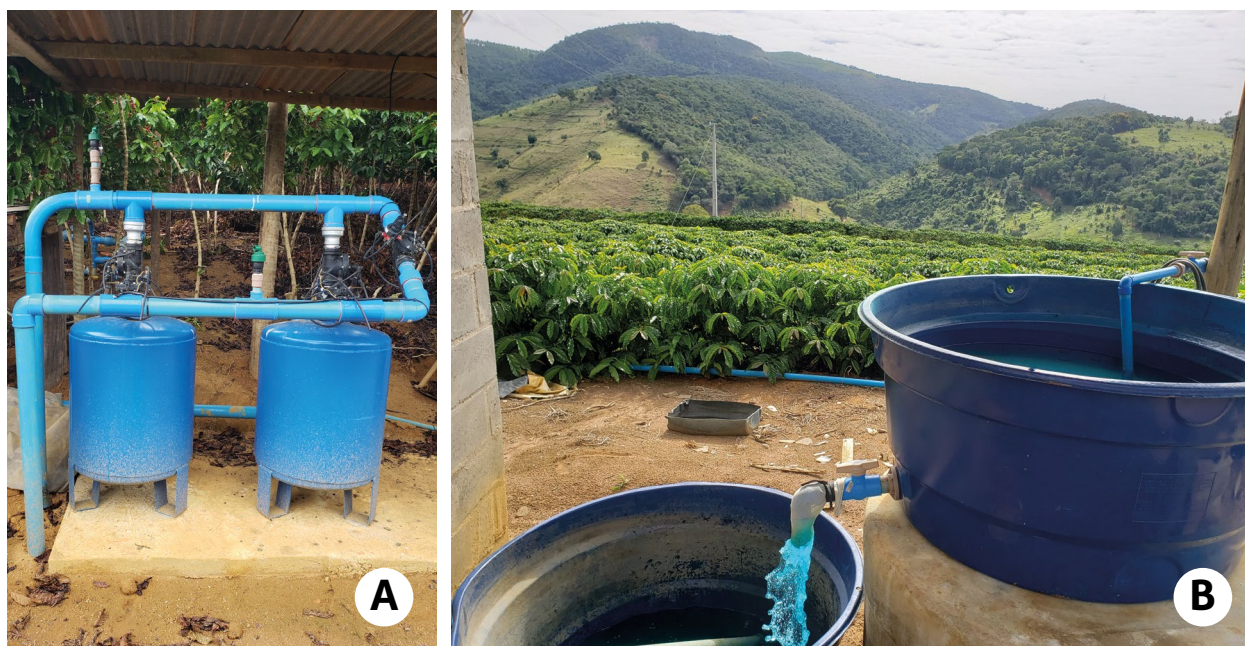
Figura 17 – Sistema de filtros (A) e caixas pvc para acondicionamento da solução (B).
